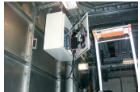
Bild 3: Der Dataeagle-Master ist außerhalb des Schaltschranks in der Nähe der Antennen in einem eigenen Gehäuse verbaut
