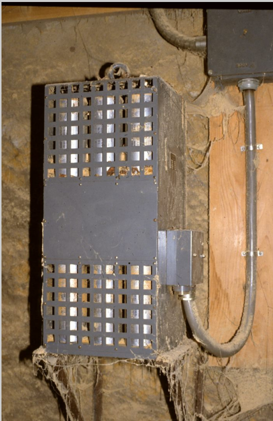
Kondensatoren in Kellerraum Kompensation in einer Schreinerei
