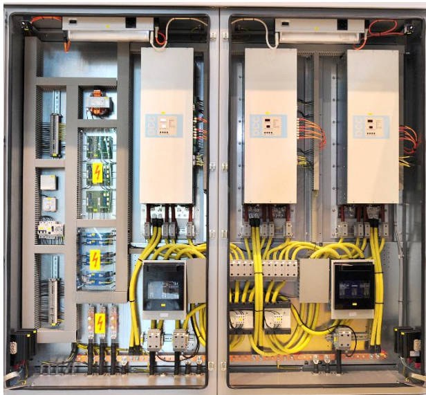
Blick in die Gleichstrom-Kompensationsanlage
